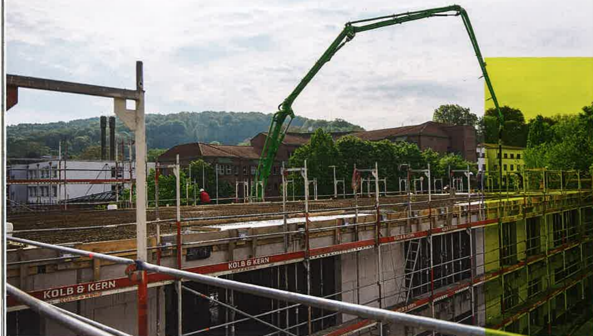
Für die Decken über Erdgeschoss und erstem Obergeschoss sowie für die Bodenplatte kam der Recycling-Beton EcoCrete 50 R zum Einsatz.
