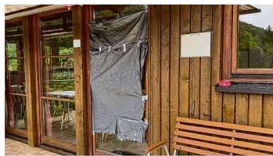
Die oder der Einbrecher haben vor allem an der Eingangstür des Tennisheims einiges an Schaden hinterlassen. Foto: Gunar Haid
